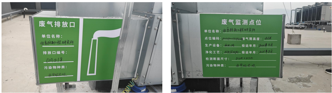
图 3-2 清洗间排气筒（DA018）
