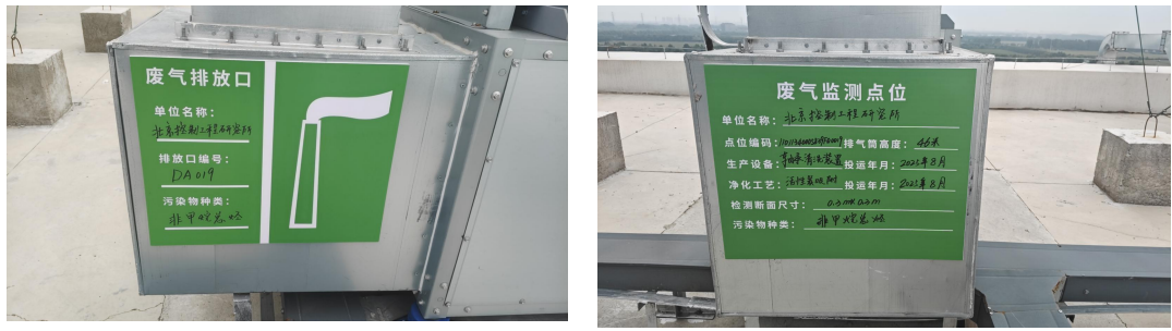
图 3-3 轴承零件清洗装置排气筒（DA019）
