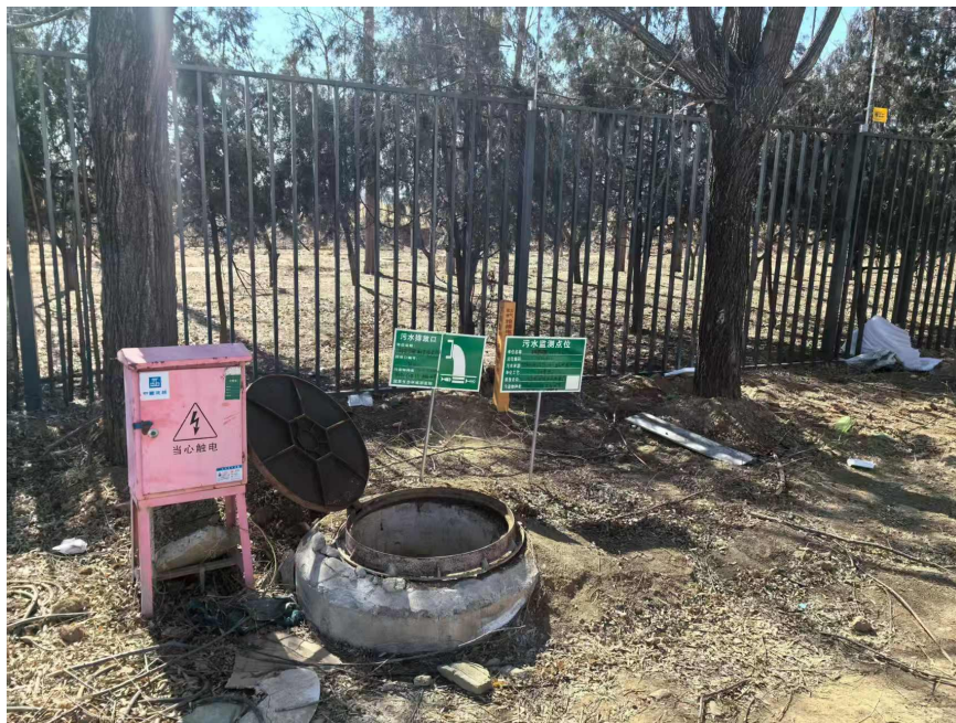
图 3-4 本项目污水总排口
